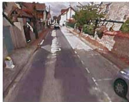
Inconfort de la traverse de la RD 114
